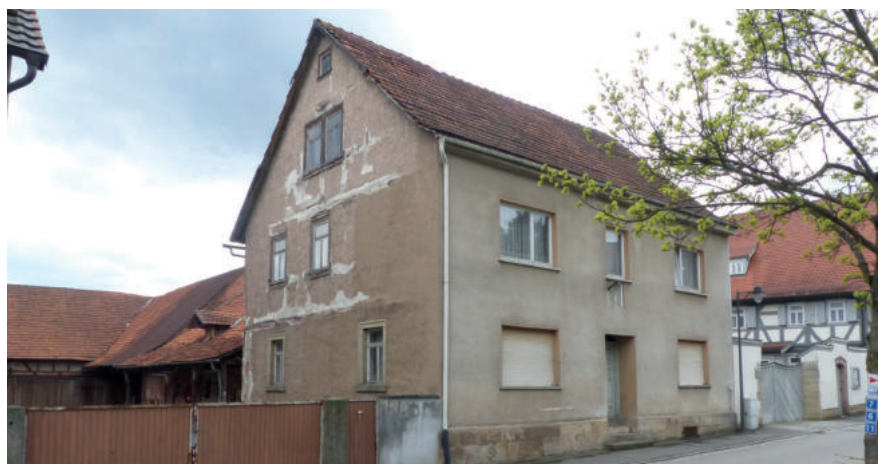
schlechter Gebäudezustand (Rathgeberstr. 3)
